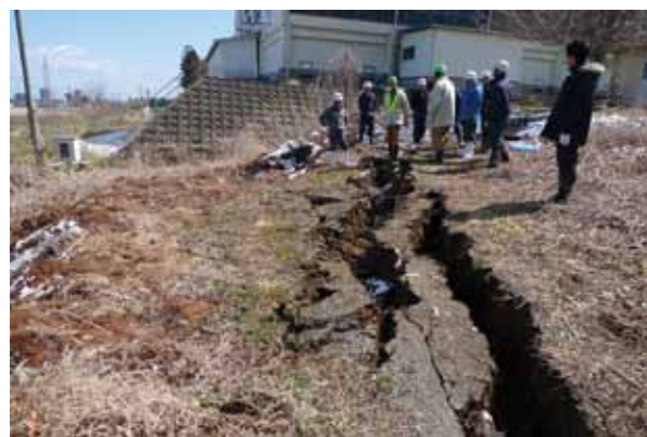
【仙台高専】名取キャンパスの敷地法面が崩落し、地割れが発生
