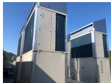
＜舞鶴高専：空調設備改修＞
