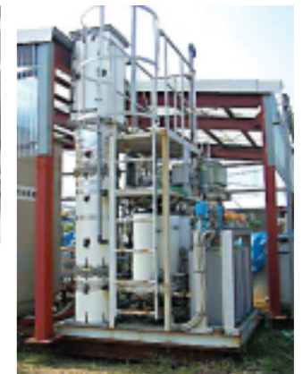
▲同処理プラントの高速メタン発酵によるバイオガス回収設備
