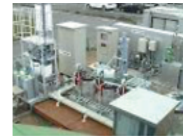
▲宇部市東部浄化センターに設置された実証実験用処理プラントの全景
