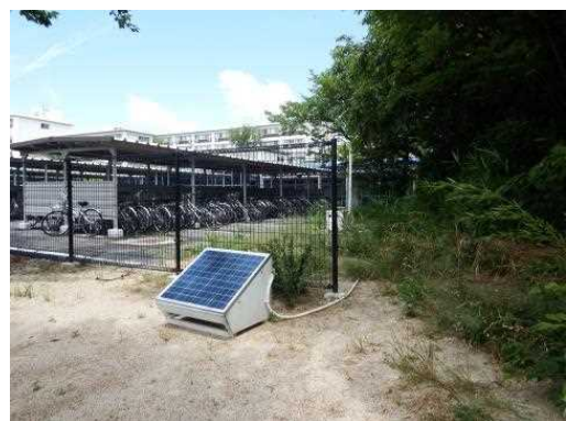
直野寮食堂近くの駐輪場に設置されたLED屋外照明 (2016.03設置)
